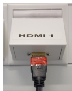
HDMI-kontakt på väggen.
